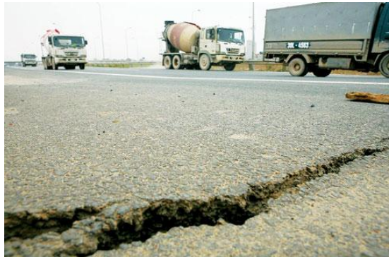
Hình 4. Rạn nứt trên Đại lộ Thăng Long
