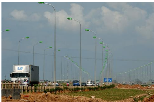
Hình 6. Hệ thống đèn cao áp đã được lắp đặt xong, sẵn sàng đi vào phục vụ
