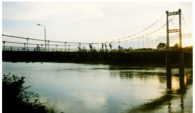
Bảo vệ cầu treo Dừng-Nghệ An bằng hệ sơn đặc chủng tuổi thọ 5 năm và mỡ đặc chủng bảo vệ cáp treo
