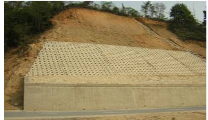
Khảo sát thiết kế xử lý sạt trượt Quốc lộ 4D
